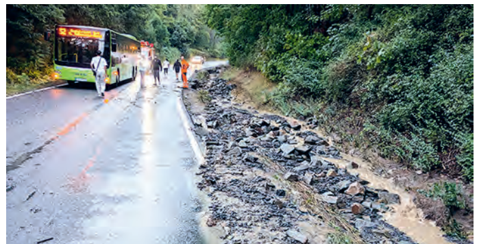
Die K 183 zwischen Unterworbach und Bad Blankenburg ist erneut von Starkregen in Mitleidenschaft gezogen worden. (Foto: SG Tiefbau)
